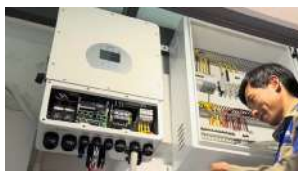
Bảo trì biến tần (Inverter)
