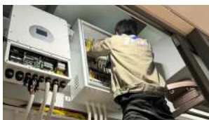
Kiểm tra điện áp và dòng điện
