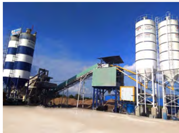
Trạm trộn bê tông 90m 3 /h Long An
