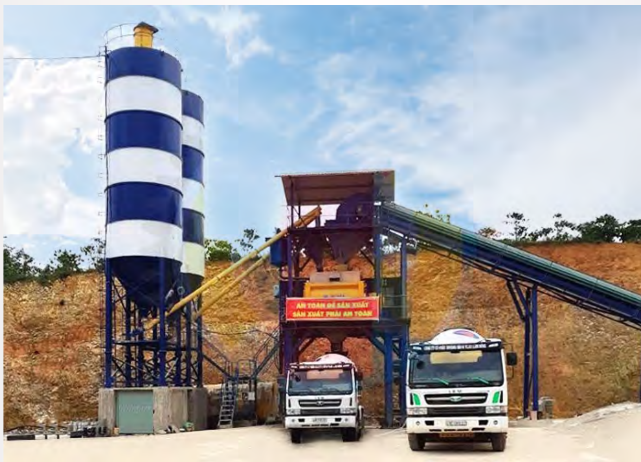
Trạm trộn bê tông 120 m 3 /h Lâm Đồng
