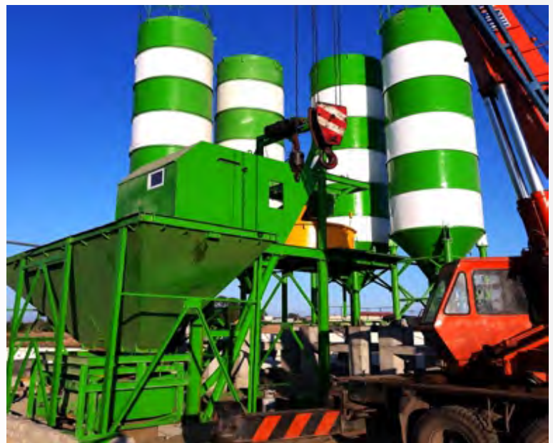
Trạm trộn bê tông tại Cần Giò
