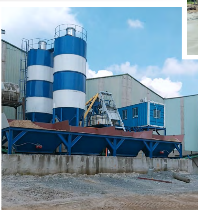
Trạm trộn bê tông Đồng Nai
