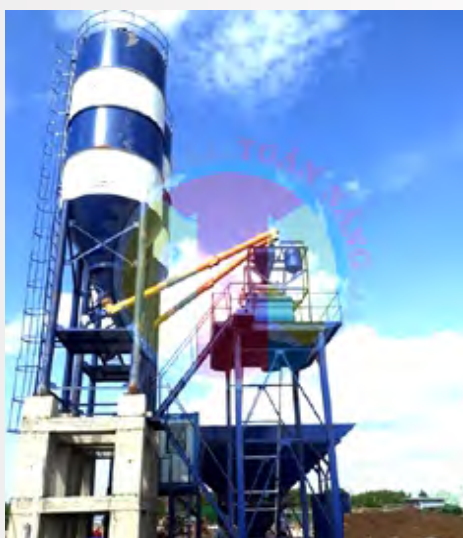
Trạm trộn bê tông tại Cà Mau
