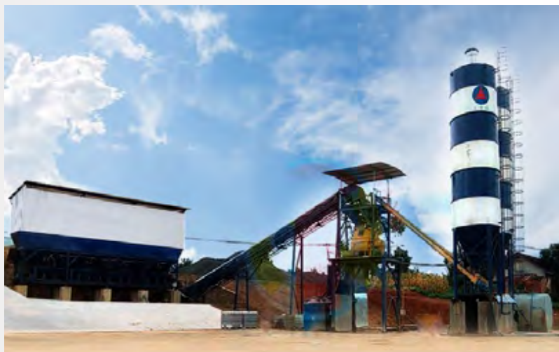
Trạm trộn bê tông tại Đà Lạt
