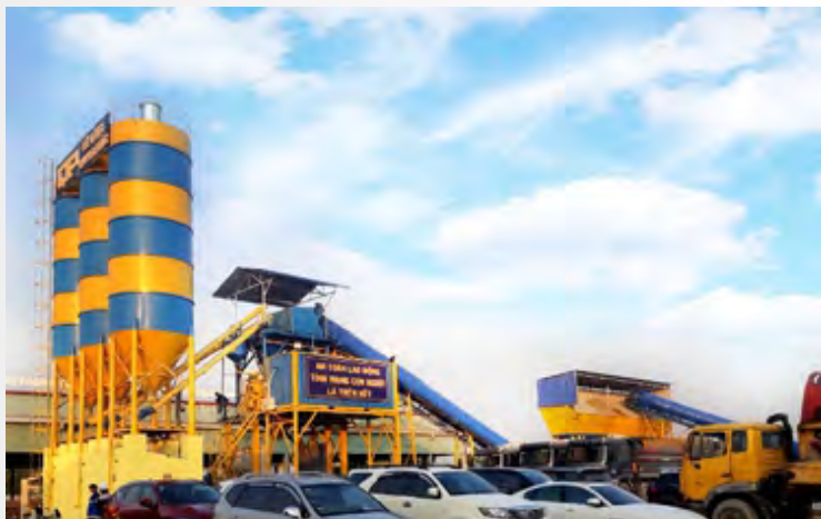
Trạm trộn bê tông 120m 3 /h Long An
