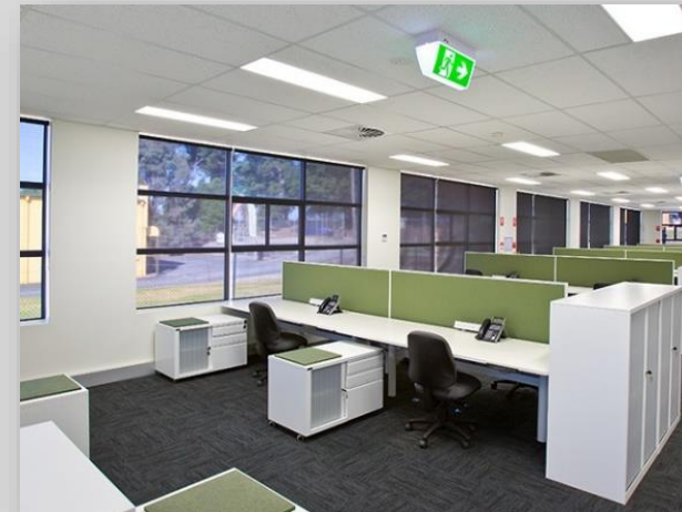
Chiếu sáng khẩn cấp/ thoát hiểm
