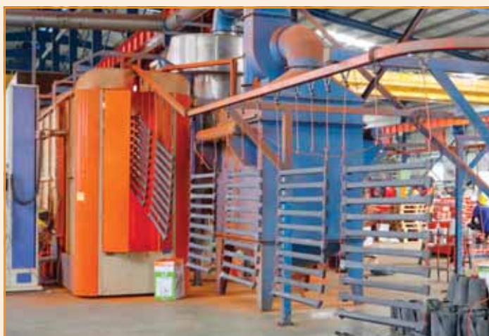
DÂY CHUYỀN SƠN TĨNH ĐIỆN TỰ ĐỘNG AUTOMATIC POWDER COATING LINE
