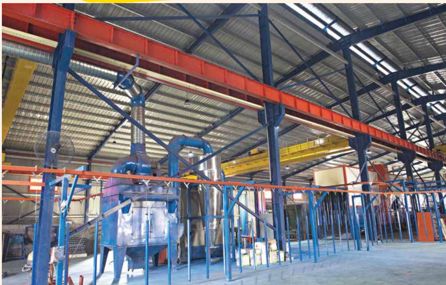
DÂY CHUYỀN SƠN TĨNH ĐIỆN - AUTOMATIC POWDER COATING LINE
